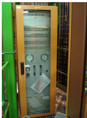
Figura 79 - Vista frontal de um rack de gás (na parte traseira encontram-se instaladas as ELMBs)
