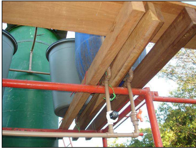
Figura 4.21 – Registros utilizados no processo de limpeza das colunas verticais de pré-filtração 1 e 3.
