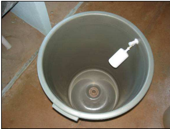
Figura 4.12 – Reservatório de 100L com bóia para controle do nível d'água.
