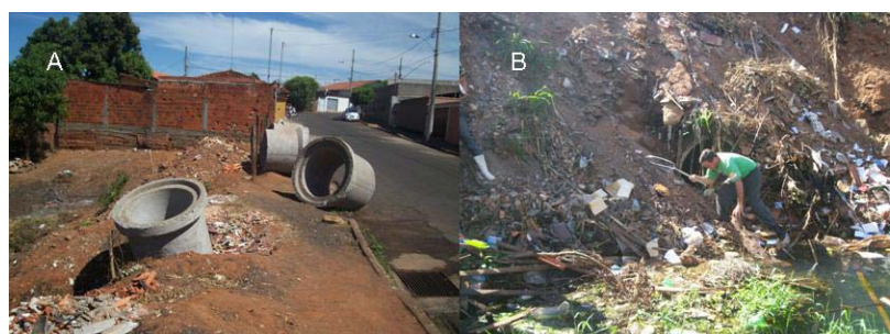
Figura 5.16: A- Galeria de águas pluviais não finalizada e depósito de entulho nas proximidades da nascente do córrego das Lajes B- Depósito de lixo na saída da galeria.
