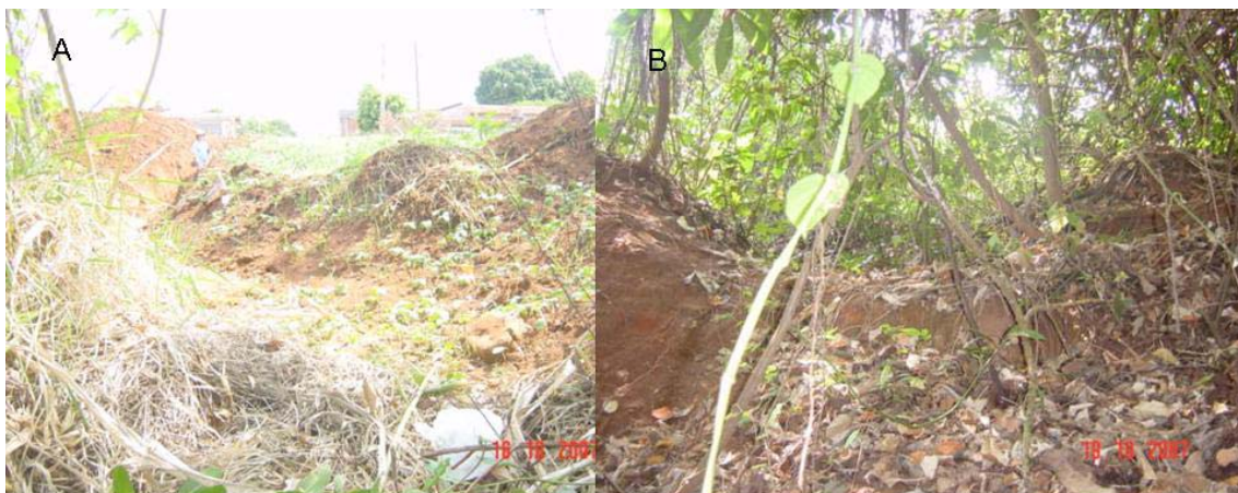
Figura 5.32: A- Visão à distância da canaleta; B- Voçoroca sendo formada pela força das águas da canaleta.
