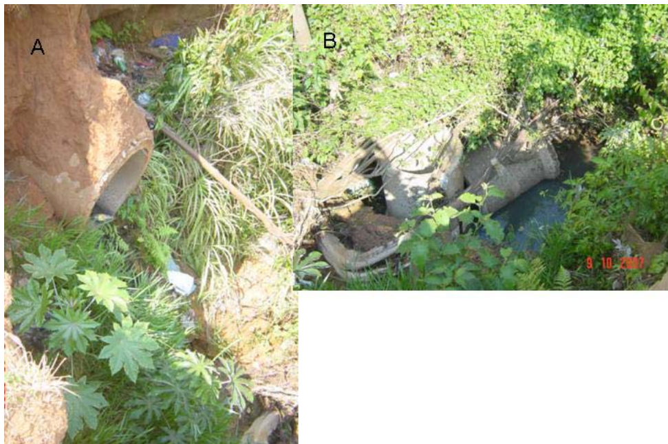
Figura 5.34: A- Final da rede de drenagem, B- Manilhas soltas dentro da voçoroca e água pluvial parada
