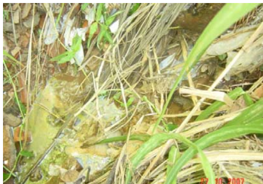
Figura 5.15: Nascente brotando em meio ao entulho.
