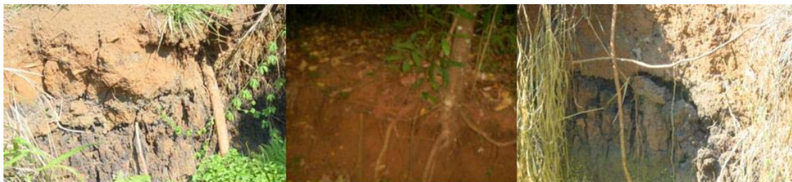
Figura 5.23: Risco de desmoronamento em barrancos atingidos por erosões.
