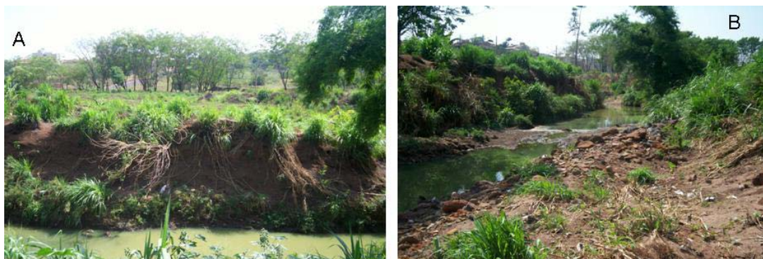
Figura 5.49: A- Talude instável com risco de desmoronamento na margem direita do Córrego das lajes. Área sem mata ciliar; B- Banco de areia assoreando o Córrego das Lajes.
