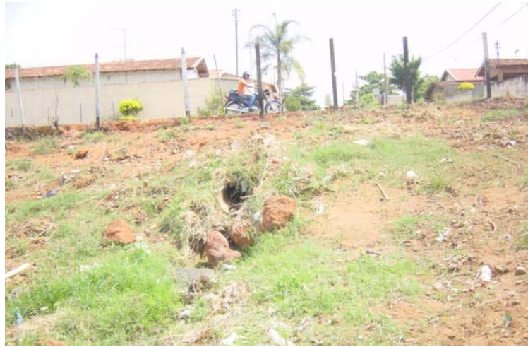
Figura 5.27: Final da rede de drenagem e concentração das águas pluviais lançadas diretamente sobre o terreno.
