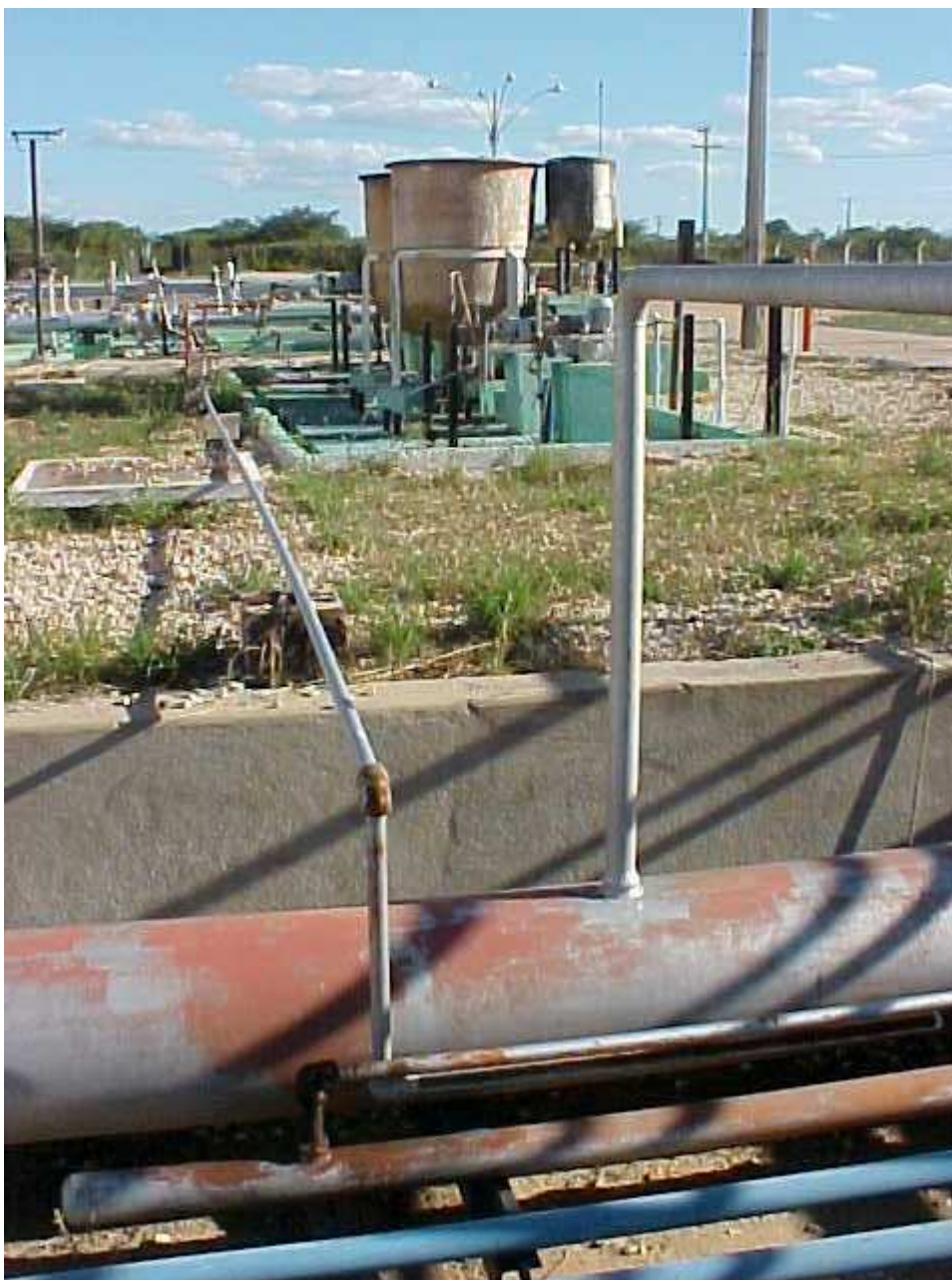
Figura 29: Vista da entrada da tubulação de injeção de produtos químicos no oleoduto.
