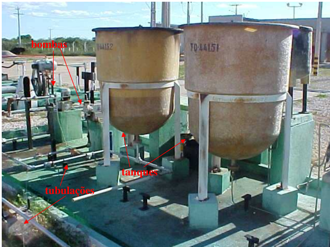
Figura 27: Detalhe da instalação em duplicidade de sistemas de injeção de produtos químicos, com tubulações independentes.
