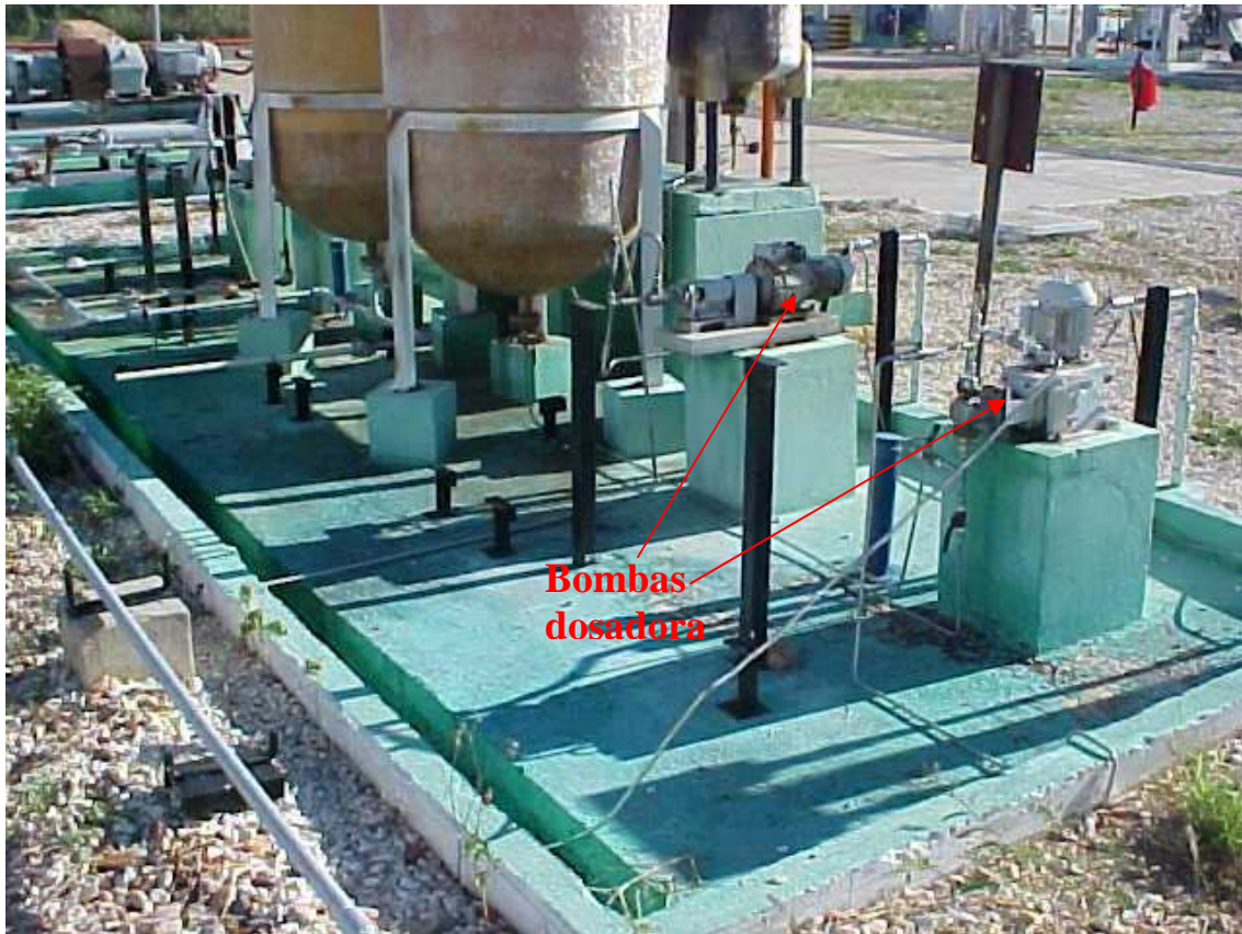
Figura 28: Detalhe de bombas dosadoras acionadas verticalmente e horizontalmente.
