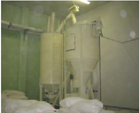
Figura 5 a – Silos de homogeneização
