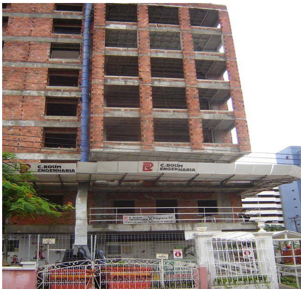
Figura 38 - Tubo Coletor de Entulho Despejando no Container
