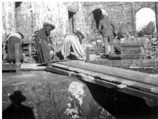
FIGURA 55 - Equipe de operários na obra de consolidação executada por Lucas Mayerhofer, entre 1938 e 1940. ANS.
