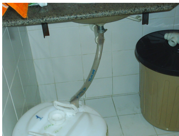
Foto 9: Coleta no lavatório.
