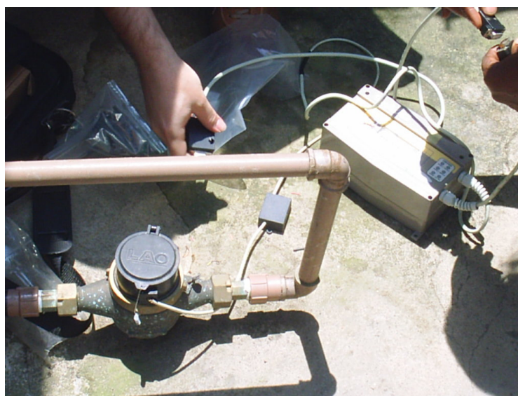
Foto 15: Hidrômetro e datalogger instalados.
