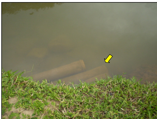
Figura 7: Rio Macabuzinho no trecho de captação de água para abastecimento de água. Seta indicando sistema de tomada de água.
