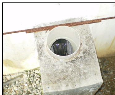
Figura 10: Ponto de coleta correspondente à saída da ETE (P 4).
