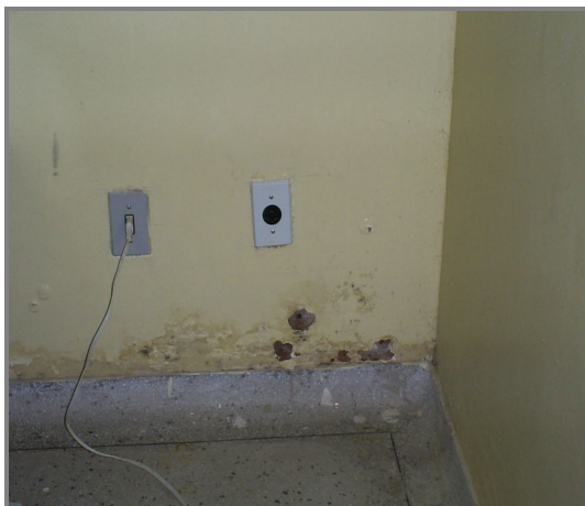
Figura 4. Sala de radiologia do CEO “B” exibindo paredes em condições precárias. Natal, RN. 2006.
