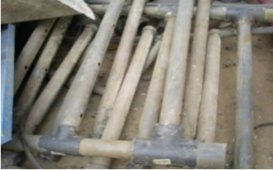
Figura 10: Armazenamento direto no piso (forma inadequada).
