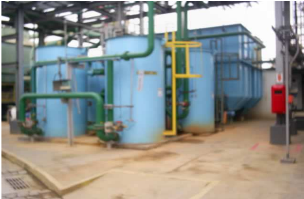
Figura 5: Estação de Tratamento de Água (fonte geradora de resíduo)
