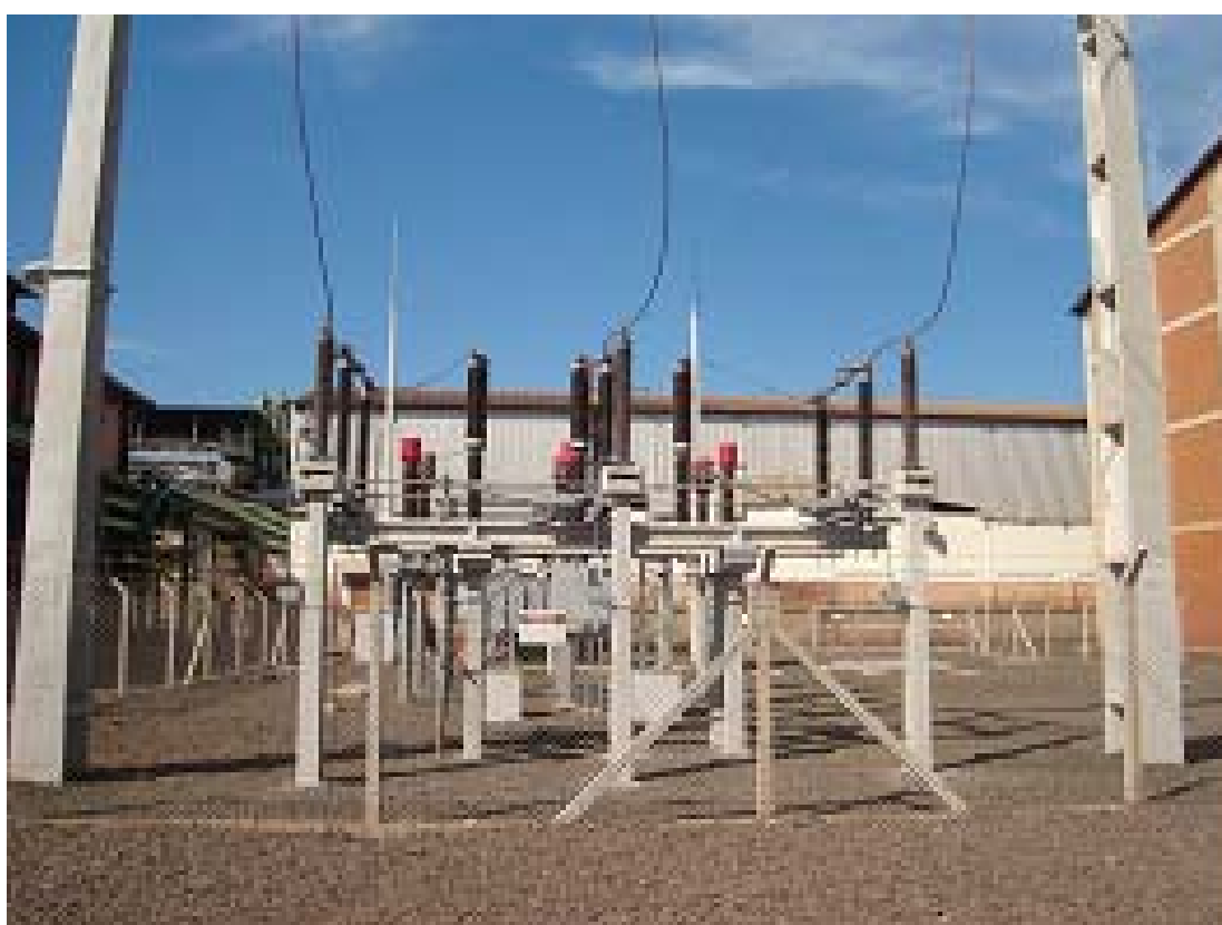
Figura 3.8: SE 13,8/138 kV UTE.
