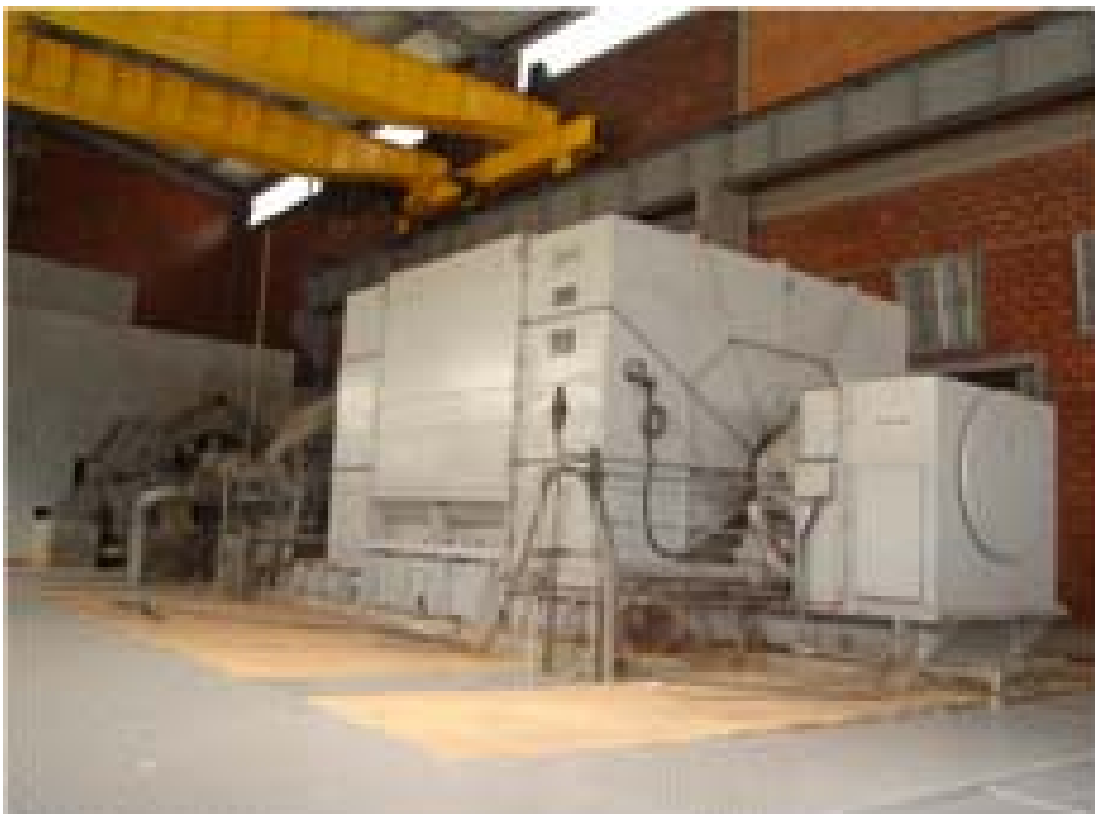
Figura 3.9: Turbogenerador de extração – condensação 32 MW
