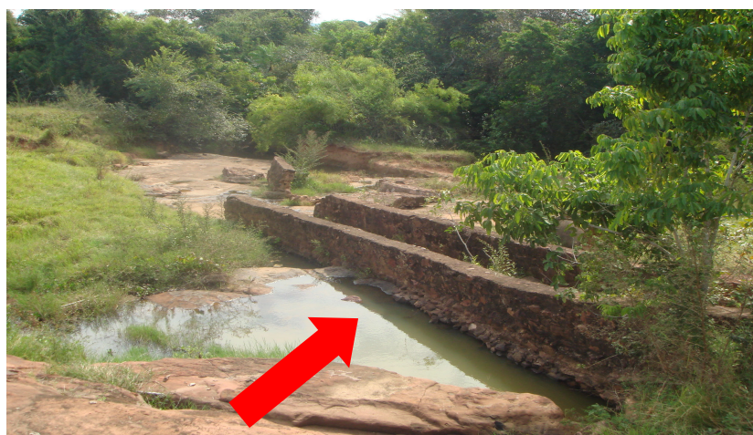
Foto 2b - Vestígios dos estragos feitos pela enchente e restos de construção no lado direito da represa
