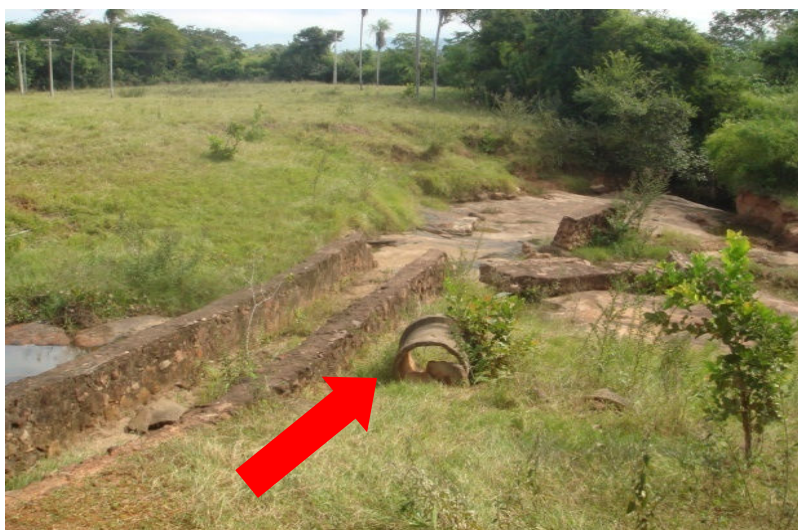
Foto 2a: - Lado direito da represa – vestígios dos estragos feitos pela enchente e restos de construção
