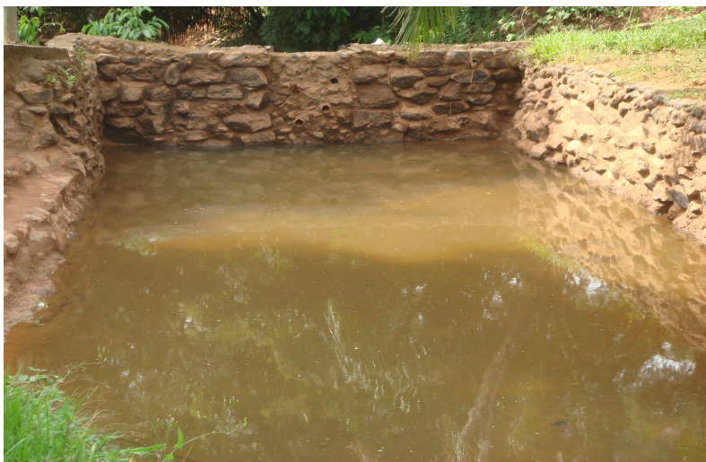
Foto 18a : Mosaico dos danos causados pela construção ilegal de represa/ Pesqueiro 110 Fonte: Levantamento de Campo 25/10/2006 e 25/03/2007
