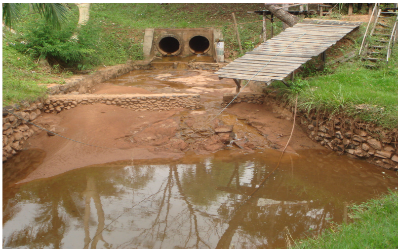
Foto 18c : Mosaico dos danos causados pela construção ilegal de represa/ Pesqueiro 110 Fonte: Levantamento de Campo 25/10/2006 e 25/03/2007
