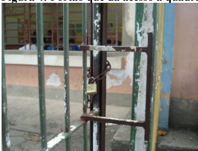
Figura 4: Portão que dá acesso à quadra
