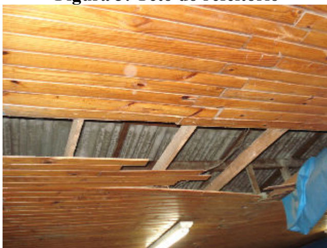
Figura 3: Teto do refeitório
