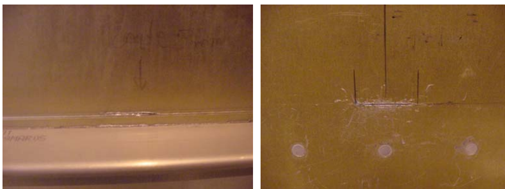
(a) – vista interna do painel e da trinca (b) – vista externa do painel e da trinca
