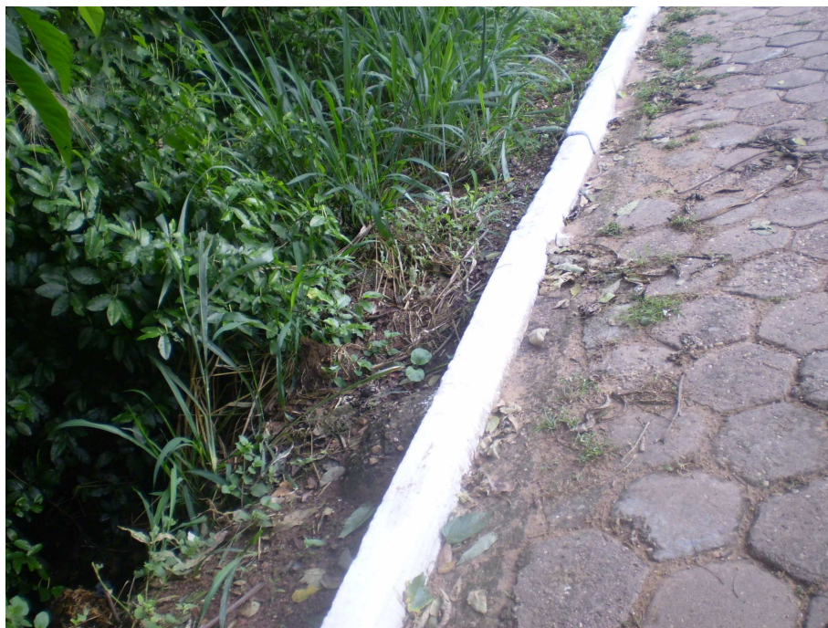
Figura 23- Parte da Rua principal com problemas de erosão à esquerda. Fonte: Arquivo da pesquisadora, fev. 2008.
