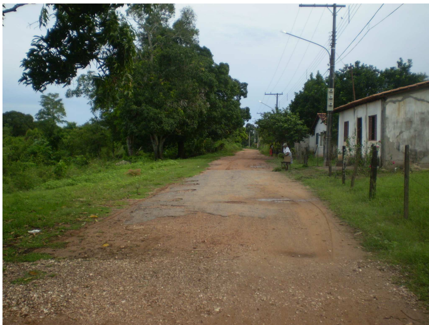
Figura 24- Parte da Rua principal com problemas de erosão à esquerda. Fonte: Arquivo da pesquisadora, fev. 2008.
