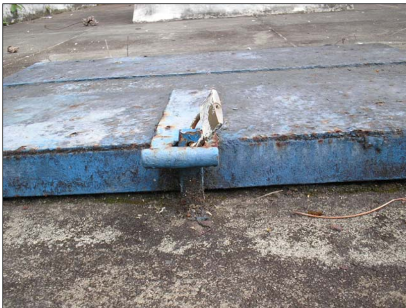
Figura 2.5: Tampão de ferro de acesso a nascente.
