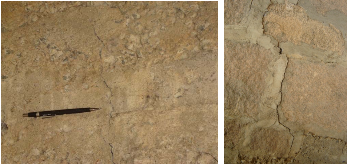
Figura 5.38 – Rachaduras nos encontros indicando excesso de sobrecarga
