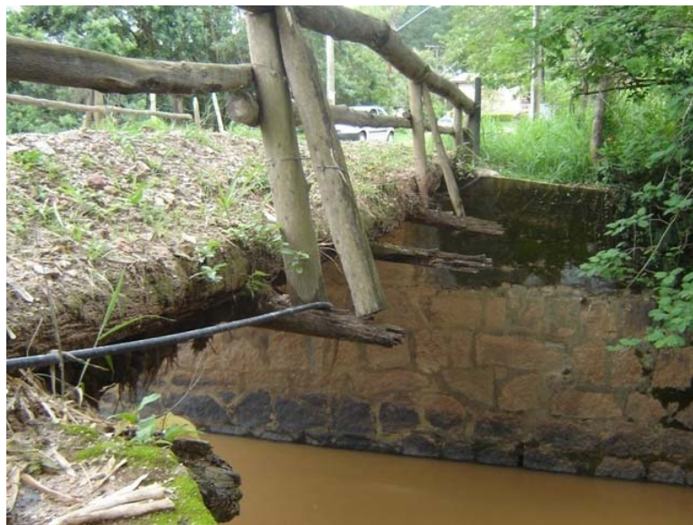
Figura 6.40 – Guarda-corpo de madeira em estado precário
