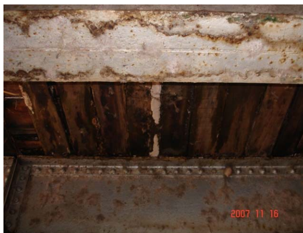
Figura 6.21 – Apodrecimento da madeira do tabuleiro por acúmulo de umidade
