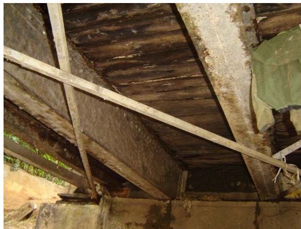
Figura 6.19 – Apodrecimento do tabuleiro de madeira
