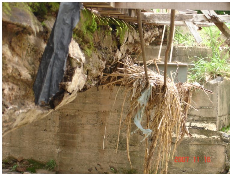
Figura 6.51 – Apodrecimento das toras de madeira que compõem a estrutura principal
