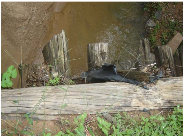
Figura 6.27 – Deterioração da madeira
