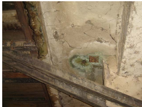
Figura 6.7 – Presença de limo por infiltração
