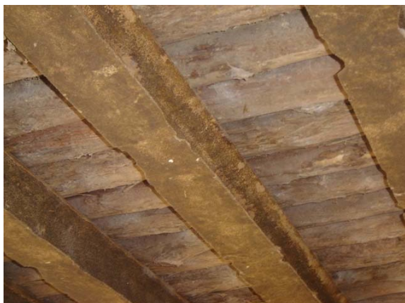
Figura 6.35 – Corrosão dos perfis
