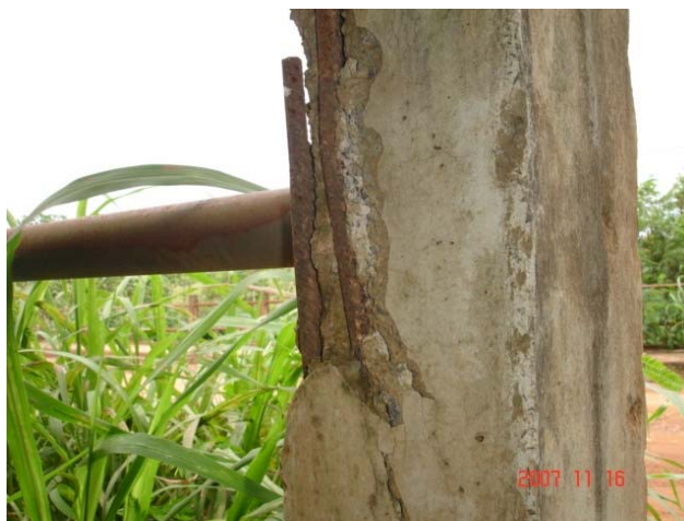
Figura 6.32 – Deterioração do guarda-corpo por corrosão
