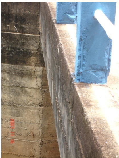
Figura 6.44 – Corrosão do aço dos guarda-corpos
