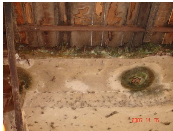
Figura 6.11 – Estado de apodrecimento da madeira do passeio
