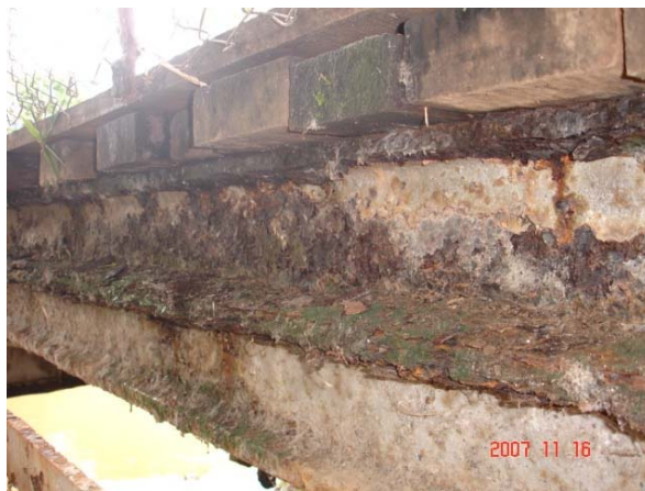
Figura 6.20 – Corrosão avançada dos perfis metálicos
