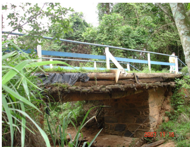
Figura 6.29 – Deformação excessiva no meio do vão da ponte
