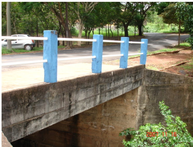
Figura 6.42 – Rachaduras nos encontros indicando excesso de sobrecarga
