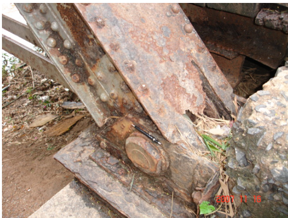
Figura 6.18 – Corrosão avançada do aço
