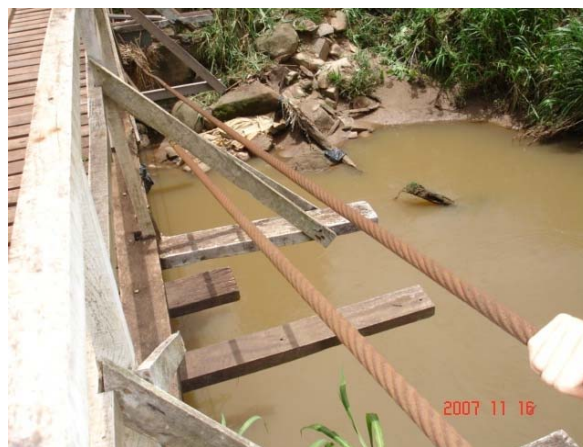
Figura 6.47 – Cabos de aço expostos
