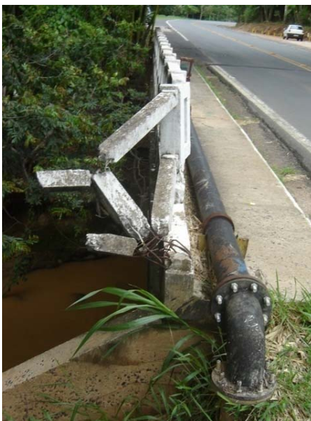
Figura 6.57 – Guarda-corpo parcialmente destruído por colisão de veículo
