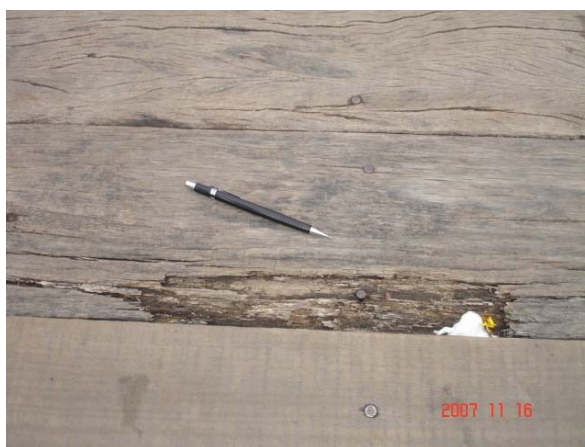
Figura 6.10 – Saliência causada pelo apodrecimento da madeira
