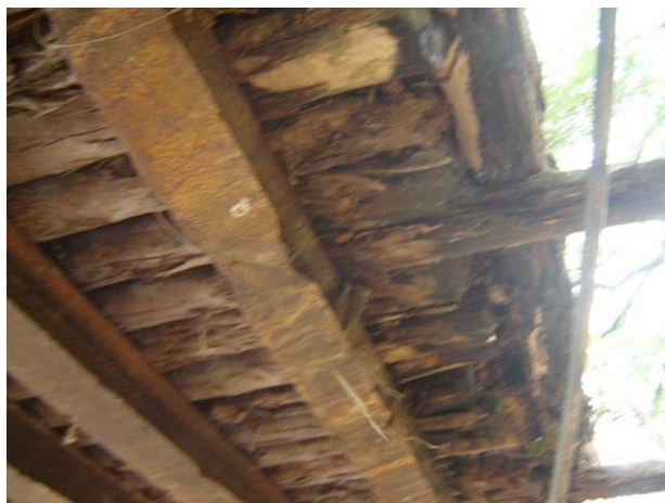
Figura 6.37 – Apodrecimento das toras de madeira que dão sustentação ao solo
