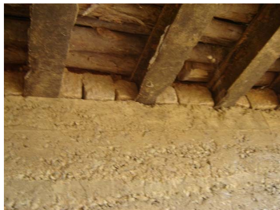
Figura 6.36 – Avançado grau de corrosão das longarinas
