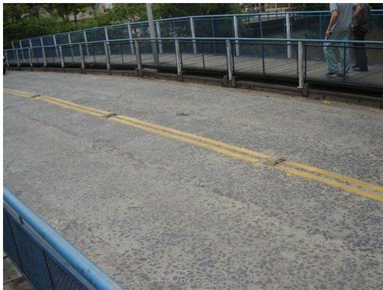
Figura 6.9 – Desgaste do concreto da laje do tabuleiro
