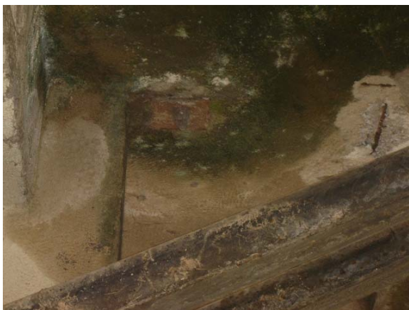
Figura 6.6 – Presença de limo e destacamento do concreto
