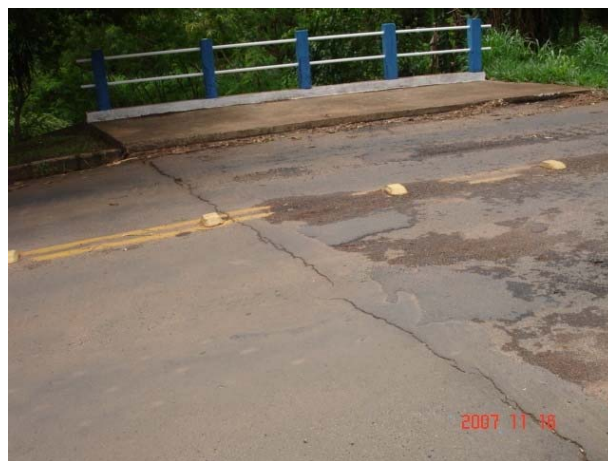
Figura 6.45 – Deterioração do pavimento
