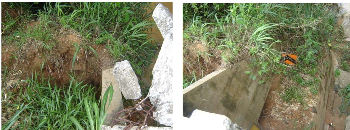
Figura 6.58 – Erosão e assoreamento junto ao encontro
