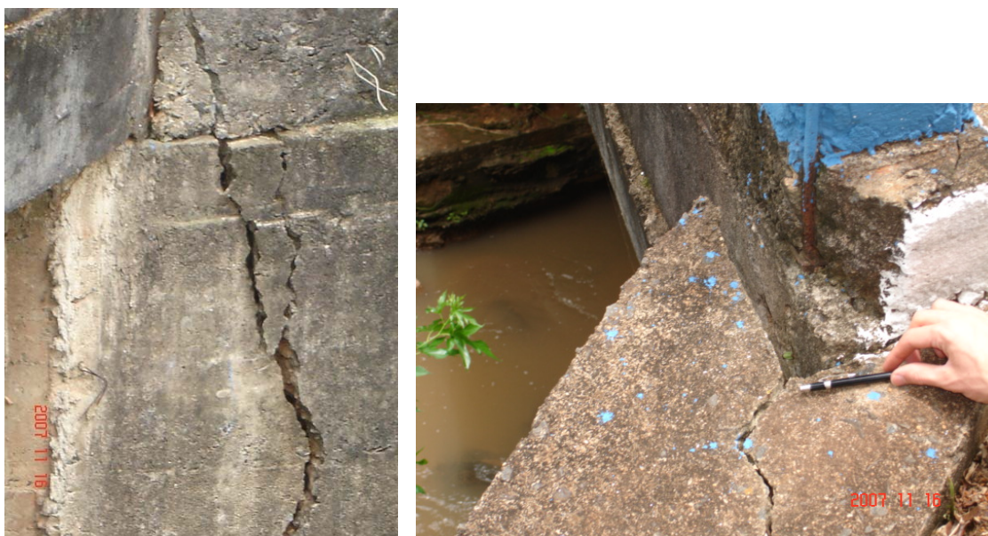
Figura 6.43 – Detalhes das rachaduras dos encontros
