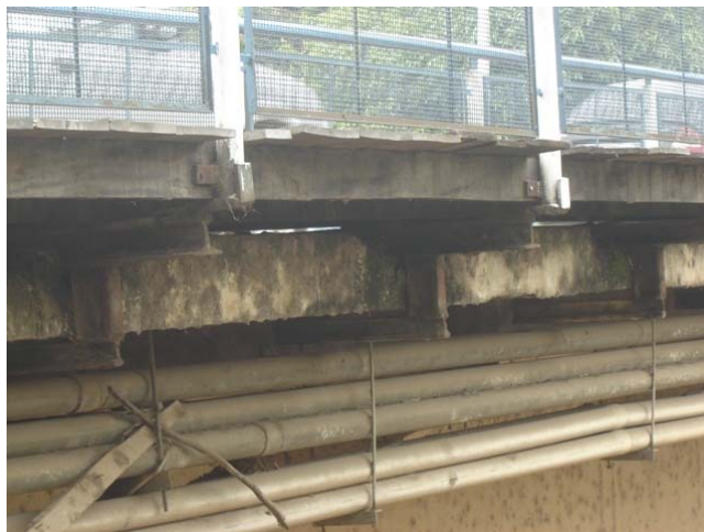
Figura 6.4 – Tubulações fixadas na estrutura
