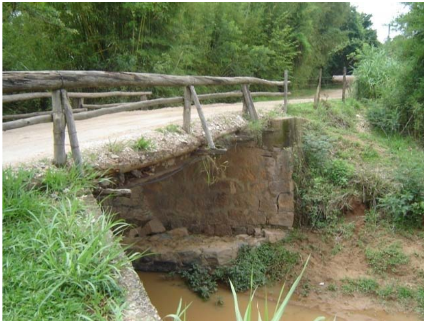
Figura 6.39 – Encontro parcialmente descalçado por efeito da erosão e má execução
