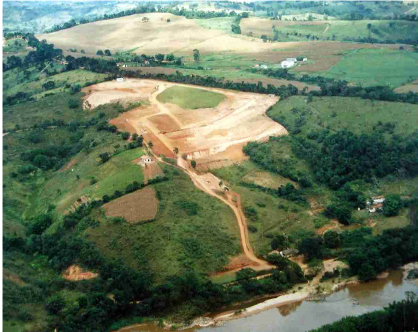
FIGURA I 10 Remoção da cobertura vegetal para criação da infra-estrutura básica da UHE FUNIL.
