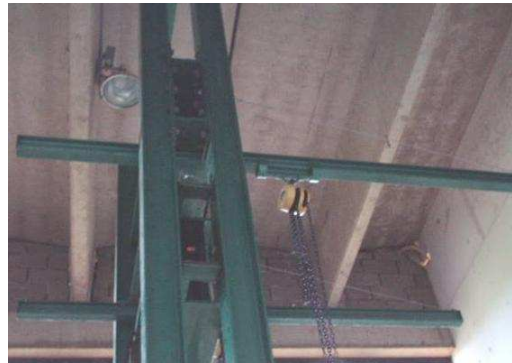
Figura 3.24 - Ponte móvel acoplada ao pórtico metálico da prensa.
