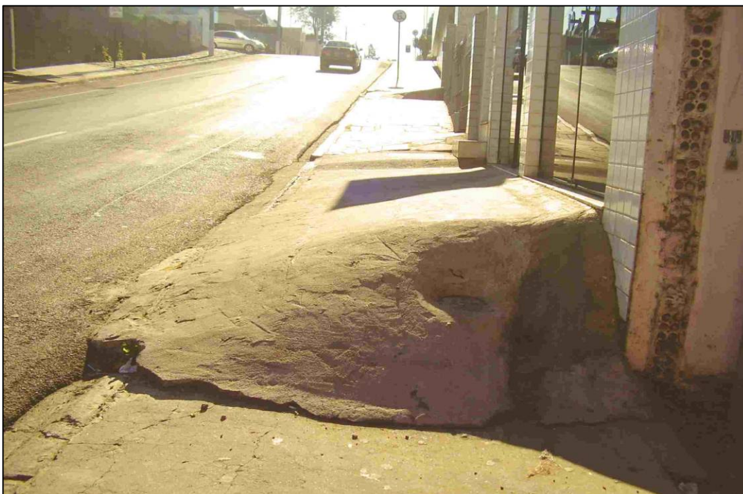
Foto 50 - BARREIRA ARQUITETÔNICA: CALÇADA COM DECLINAÇÃO ACENTUADA (Rua Comendador Norberto - Centro) Fonte: Foto do autor (2008)
