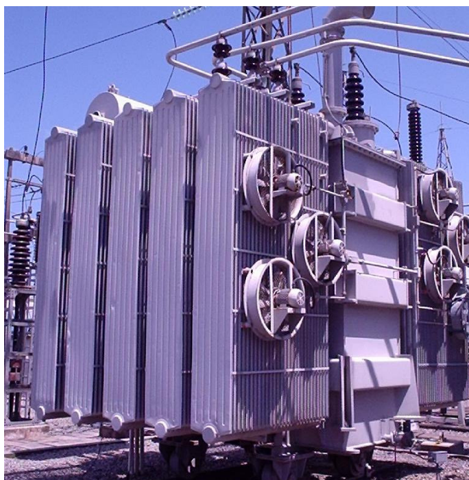
Figura 2.1 – Transformador de potência.
