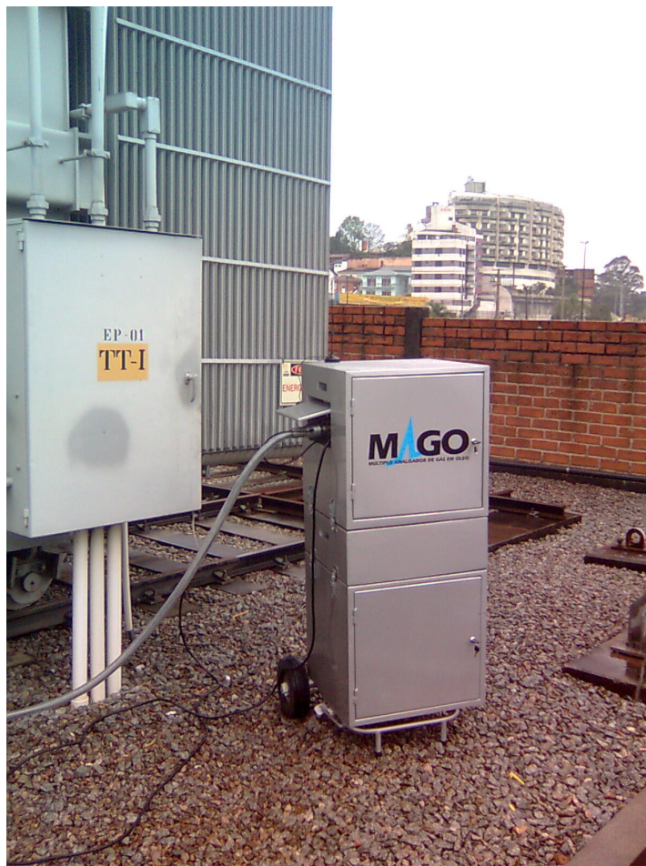
Figura 5.3 – MAGO II em testes na subestação de Coqueiros.
