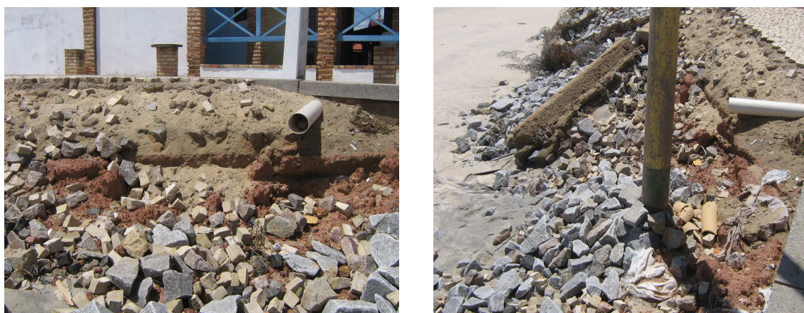
Figura 10: Comprometimento de estruturas urbanas, por efeito erosivo do mar.
