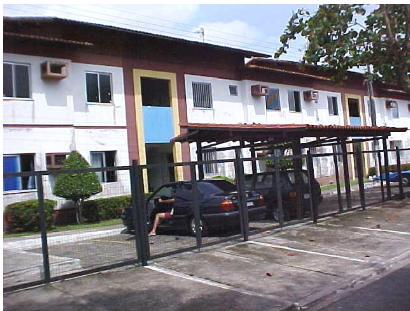
Figura 4.26 - Construção de coberturas em frente ao bloco virado para a rua. Fonte: Fotografia do autor.
