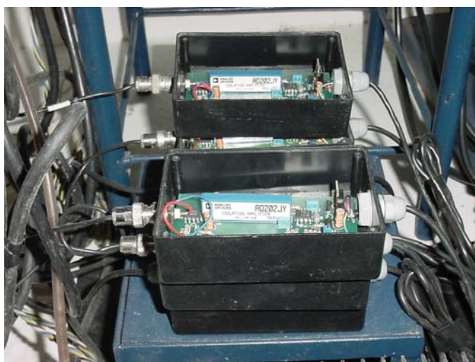
Figura 4.5 - Amplificadores – transmissores de sinais.
