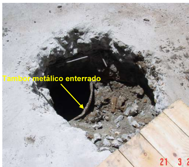
Figura 4.14 – Tambor metálico enterrado no subsolo
