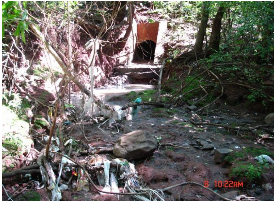
Figura 23 Saída de esgoto pluvial: Parque do Ingá (Maringá-PR).
