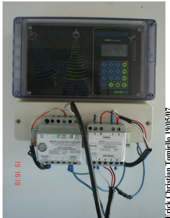
Figura 5.5 – Painel digital do equipamento para medição de vazões – ETE 01 Norte
