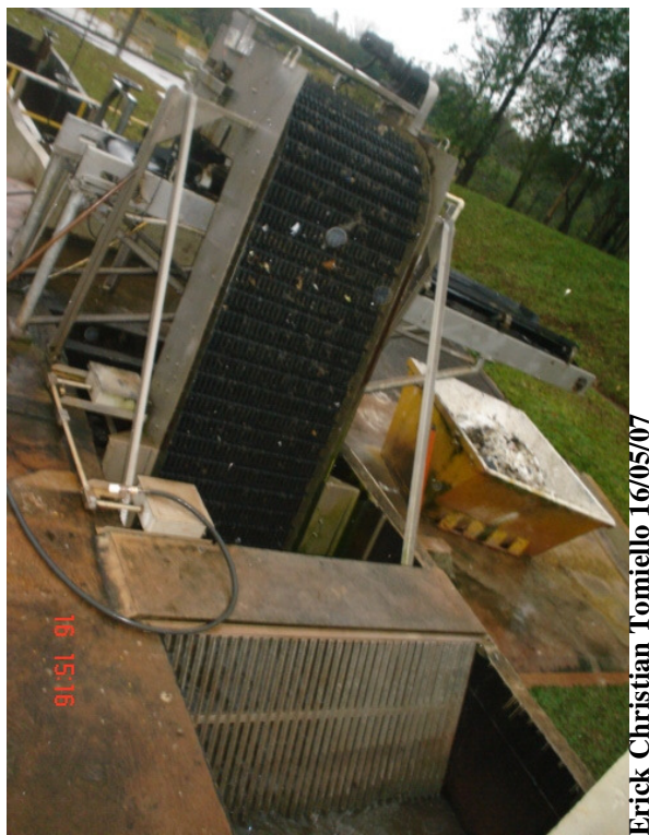
Figura 5.7 – Gradeamento grosseiro e mecanizado – ETE 02 Sul
