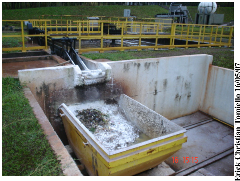
Figura 5.8 – Desarenador com remoção mecânica de areia – ETE 02 Sul
