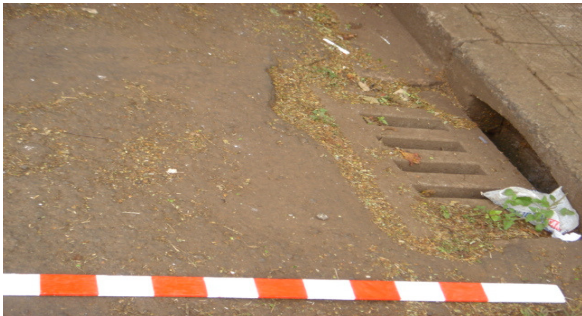
Figura 5.9 Drenagem ineficiente e condição do pavimento.
