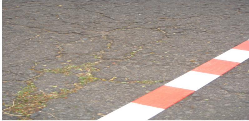
Figura 5.7 Trinca interligada da seção de pior condição
