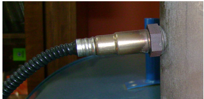
b) Sensor conectado ao duto de chaminé.
