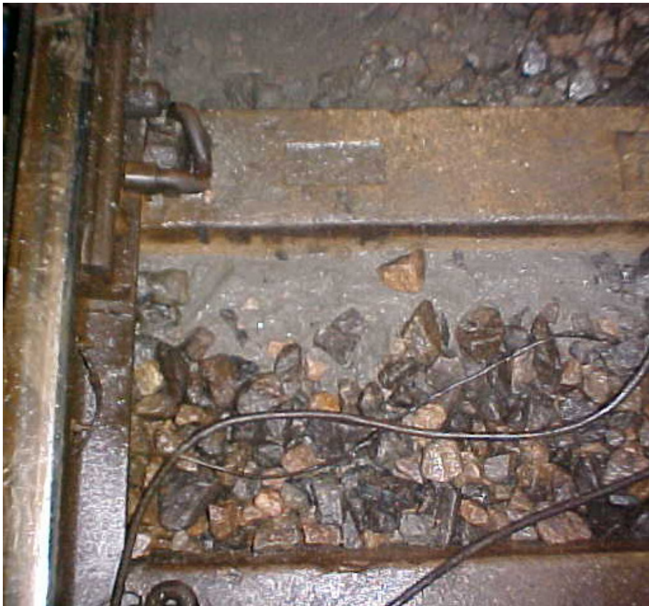
FIG 9.1: A Colmatagem no Lastro na Região de Juntas Isolantes Encapsuladas
