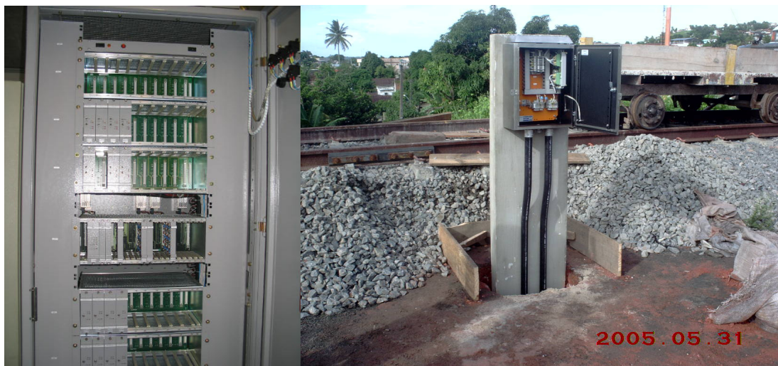
Gabinete ECV – Eletrônica de Circuitos de Via e Caixa de Interface
