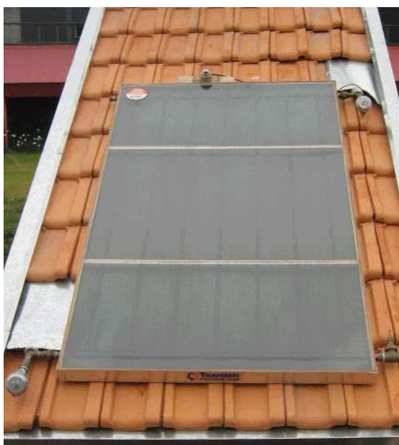
Figura 8 - Vista frontal do coletor – posição da fotografia: norte – sul. Lados esquerdo inferior e direito superior, os sensores de temperatura. Lado direito inferior, registro de manobra para drenagem do coletor.
