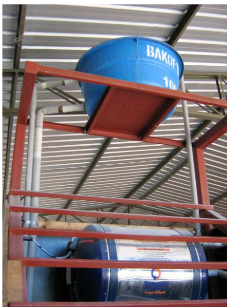
Figura 12 - Reservatório de água fria na parte superior. Na parte inferior, vista de parte do reservatório térmico.
