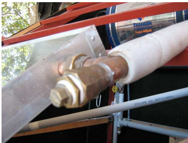
Figura 13 - Isolamento térmico em polietileno expandido, recobrindo o tubo de cobre.
