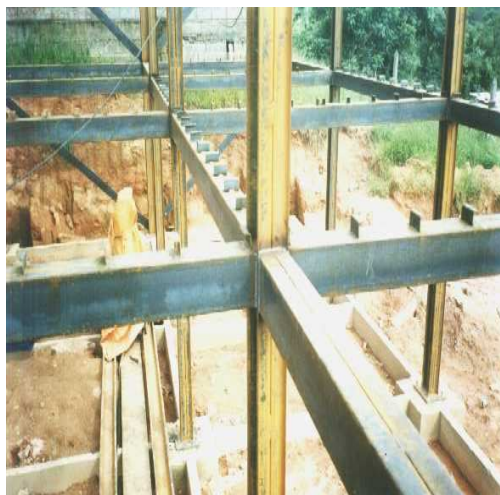
Figura 1.3 – Detalhe das ligações e das vigas mistas dos prédios desenvolvidos na UFMG para a COHAB-MG
