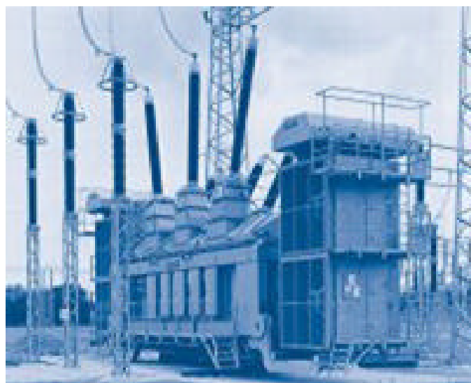
Figura 9 – Modelo de transformador de alta potência Fonte: Site da empresa em estudo.
