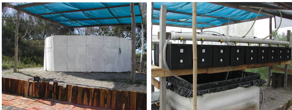
Figuras 15 e 16 – Tanque matriz, esquema de recirculação e reservatório de “água clara” utilizados neste estudo (Fonte: Arquivo pessoal)
