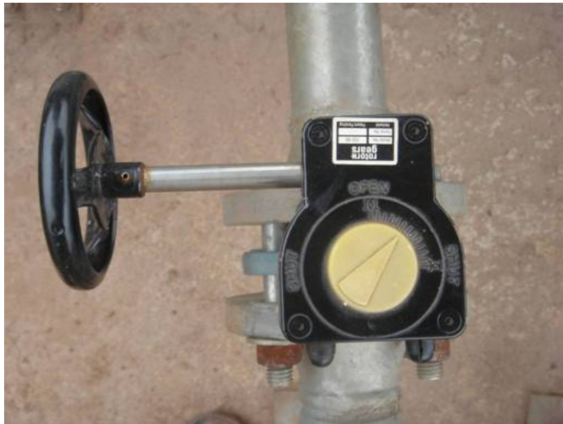
Figura 24 – Válvula tipo borboleta usada para a regulagem em cada poço ligado ao coletor. A válvula possui 12 posições de regulagem (na foto a válvula está na aberta na posição seis (6)).
