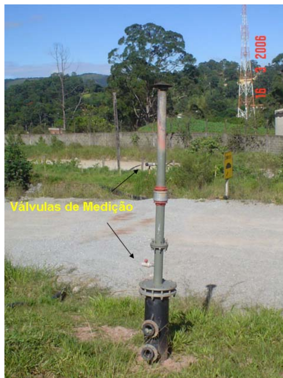
Figura 26 – Foto da chaminé instalada em cima do poço de biogás para o estudo de poços com exaustão passiva (Fonte: Biogás Energia Ambiental S.A).
