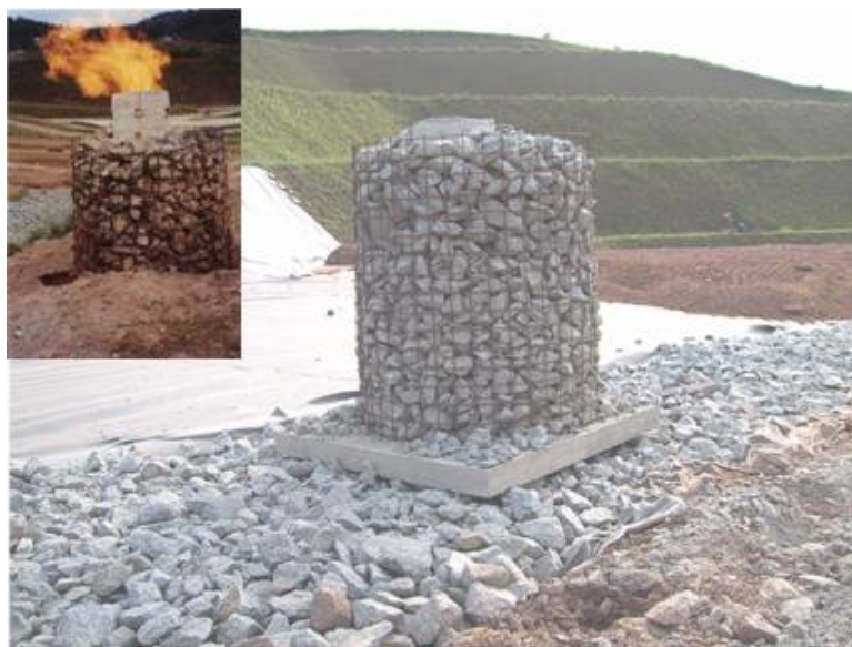
Figura 8 – Sistema de drenagem de gás e chorume. Na foto, temos o dreno horizontal e vertical e o dreno queimando gás após acomodamento dos resíduos. Foto do Aterro dos Bandeirantes – SP.
