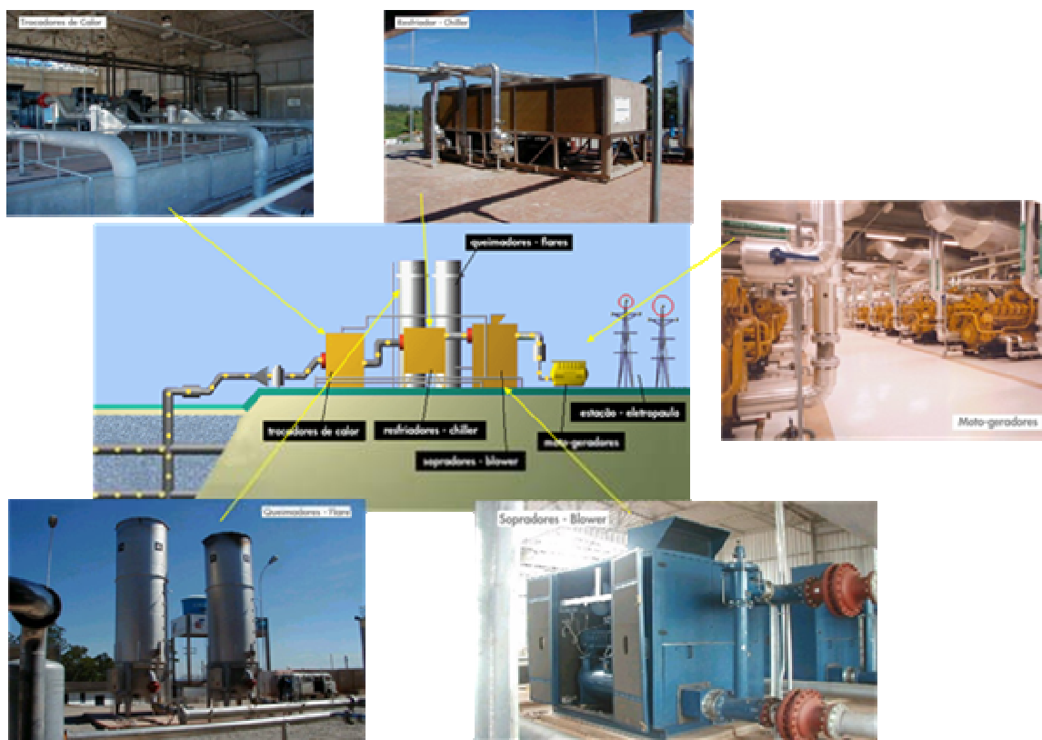
Figura 19 – Esquema de chegada de gás na Usina até a moto-geração da Usina Termelétrica dos Bandeirantes – SP (Fonte: Biogás Energia Ambiental S. A).
