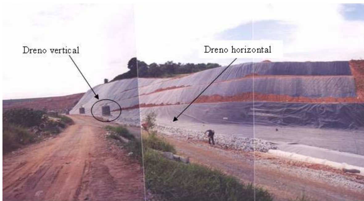
Figura 7 - Etapa de impermeabilização do terreno do futuro aterro sanitário com os drenos horizontais e verticais. Foto do Aterro dos Bandeirantes – SP.
