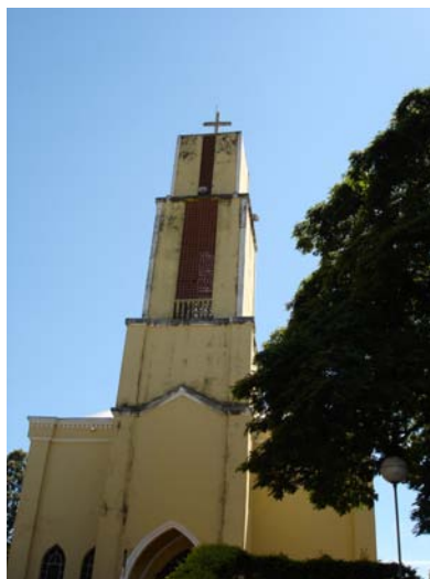
Fig 7.6 - Aparelhos de alto-falantes na torre da igreja de Alfredo Marcondes.
