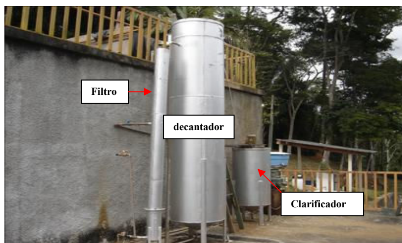
Figura 5.5: Vista parcial da ETA piloto.
