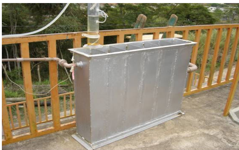
Figura 5.8: Vista lateral do floculador da ETA Piloto.
