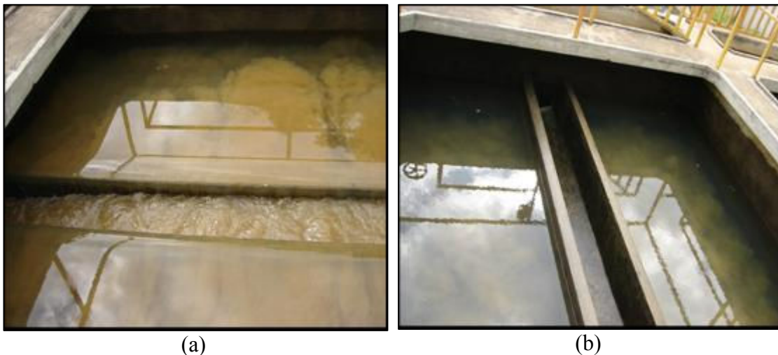
Figura 4.4: Início (a) e fim (b) da operação de lavagem dos filtros da ETA UFV.
