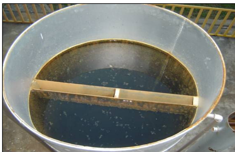
Figura 5.9: Vista superior do decantador da ETA piloto.
