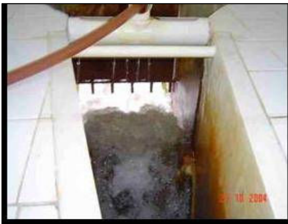
Figura 4.1: Detalhe da calha Parshall da ETA UFV.
