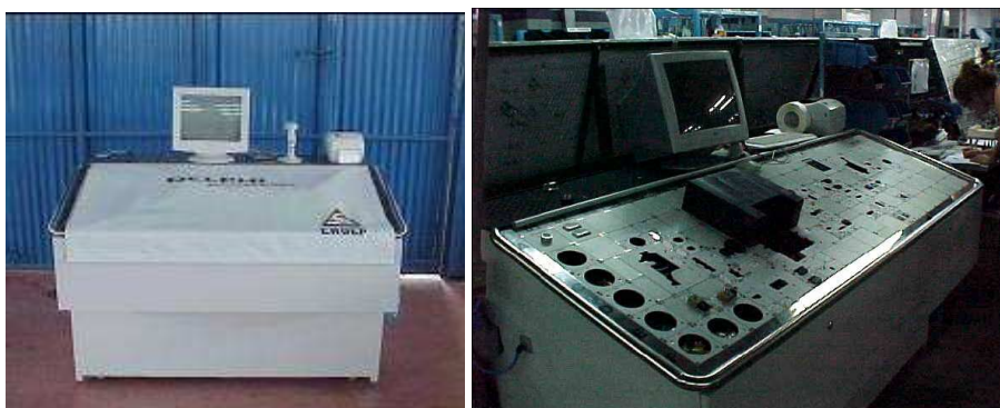
Figura 5.6 – Mesas de teste elétrico
