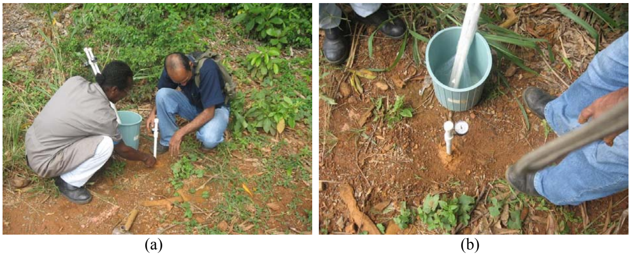
Figura 4.8 – Instalação dos tensiômetros no talude do Alto do Bom Viver.
