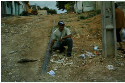
Figura 28 - Tubulação de Ferro (150 mm) na Rua Marechal Rodon Pacheco.
