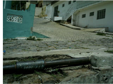
Figura 29 - Tubulação de Ferro (50 mm) na Rua Tenório de Brito – Xucurus.
