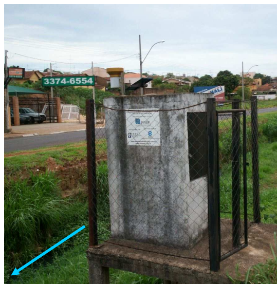
Figura 20: Detalhe do posto – Estação Fórum, localizada na bacia do Córrego Gregório. (Foto: TFS, 01/11/2007)
