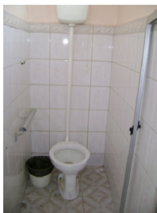
Fig. 53 – Cabine vaso sanitário enfermaria feminina: ausência de tampas dos vasos sanitários, barras laterais e porta destruída. Fonte: autora
