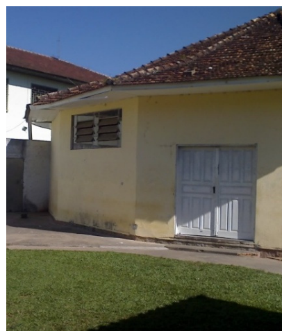
Fig. 65 – Desnível existente, sem rampa, no principal acesso ao espaço de atividades terapêuticas (pátio 2ª enfermaria masculina). Fonte: autora
