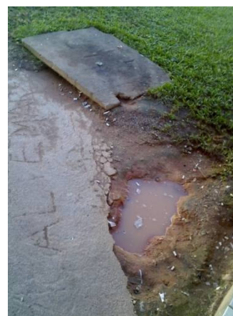
Fig. 44 – Irregularidades e acúmulo de limo em área molhadas do pátio masculino. Fonte: autora
