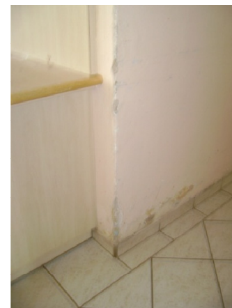
Fig. 52 – Desgaste das quinas do reboco, circulação principal da enfermaria feminina.
