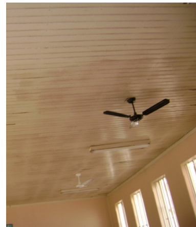
Fig. 34 – Forro da enfermaria feminina: em madeira pintada de branco, apresentado sinais de infiltração e mofo. Fonte: autora
