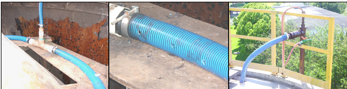
Figura 4.12 - Sistema de drenagem de lodo na base da região de sedimentação, no topo do reator de leito expandido, com detalhe para furos no tubo corrugado de 100 mm.
