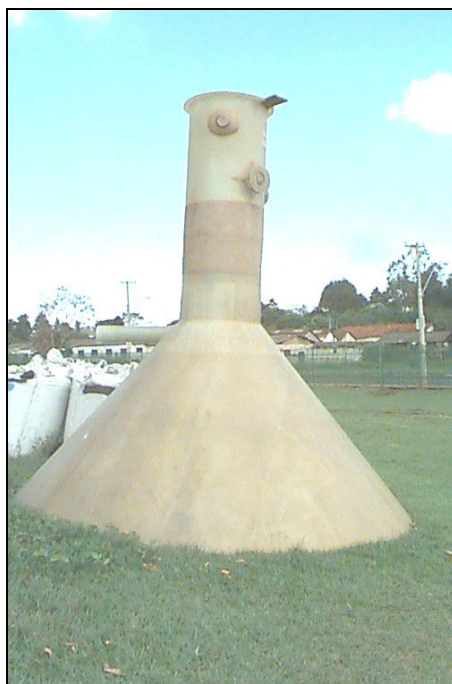
Figura 4.10 – Separador trifásico em fibra de vidro, instalado na base da zona de sedimentador, no topo do reator.
