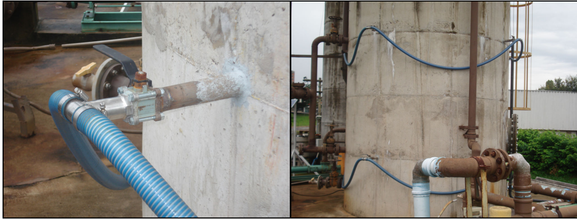
Figura 4.14 – Sistema de limpeza da corrente recirculada aeróbia com detalhe para válvula globo para descarte de sujeira.
