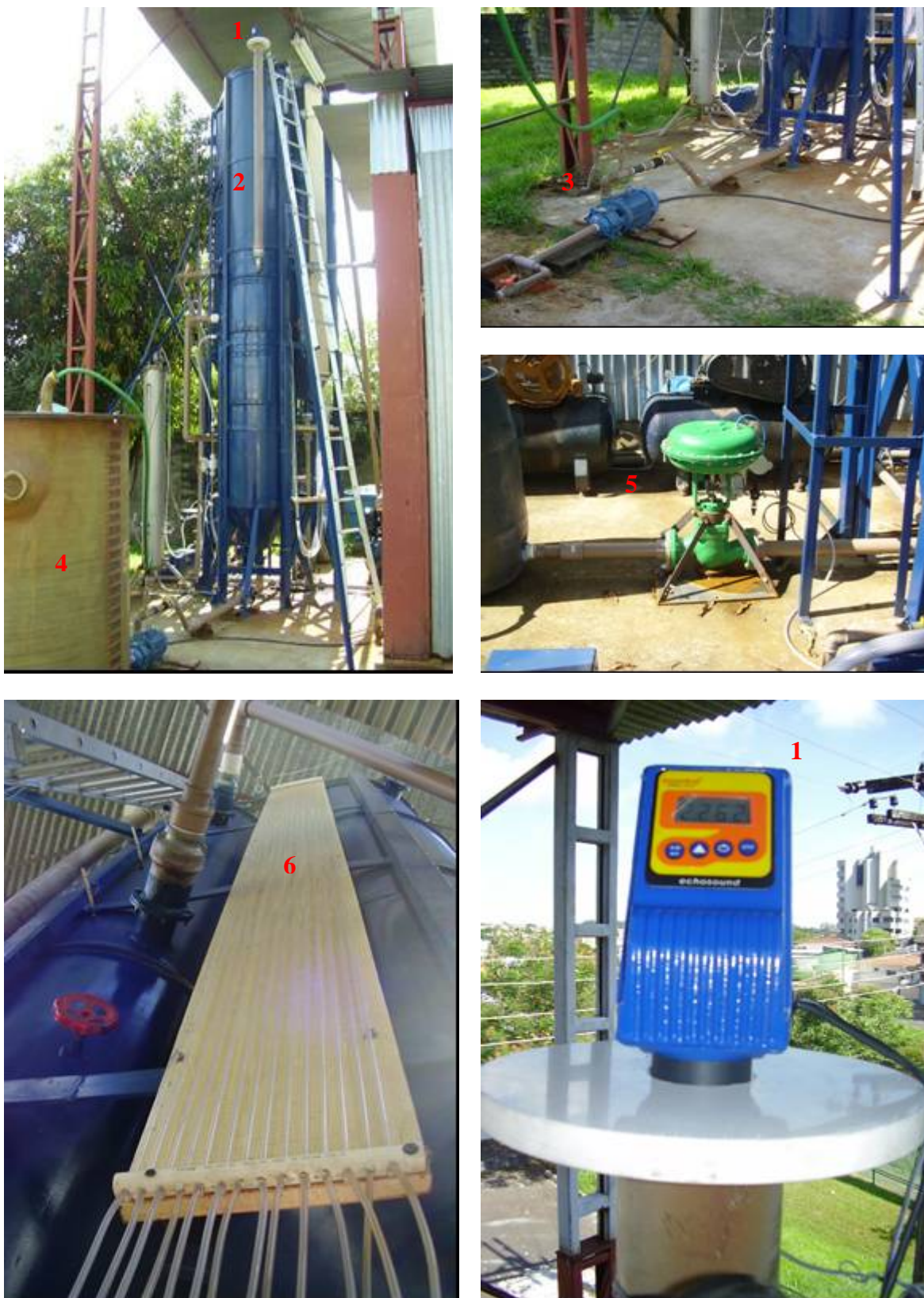
Figura 4.11 - Fotografias dos equipamentos pertencentes à instalação experimental utilizada estritamente na etapa 2 da fase 2 do trabalho experimental
