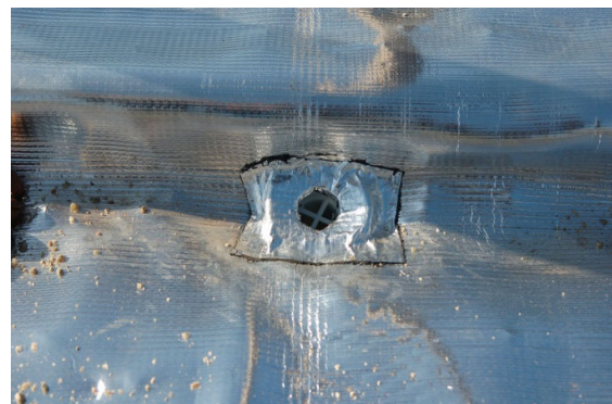
Figura 55 – Drenagem para água pluvial excedente
