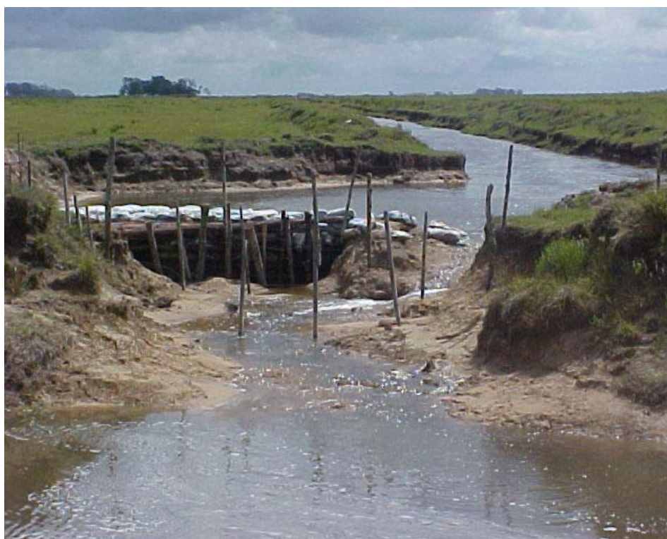
Figura 5: Arroio Chuí: Barramento (ataca mar) realizado por orizicultor a montante. Fonte: FEPAM, 2006
