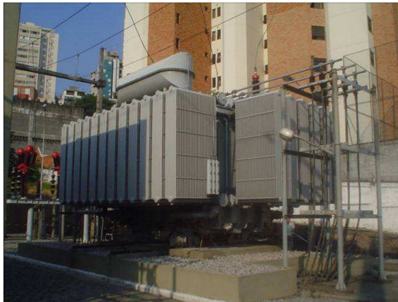
Figura 4.1: Transformador regulador de potência 30/40 MVA, 138-13,8/11,95 kV
