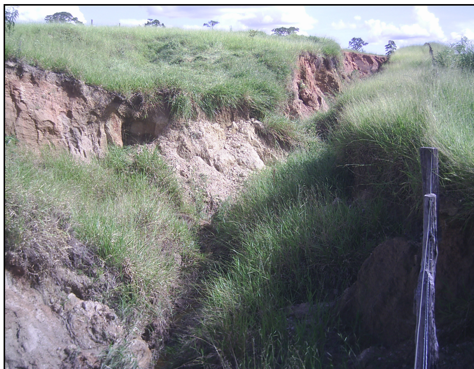
Foto 7 – Erosão GO-209 Sub-bacias do Ribeirão das Areias Coordenadas geográficas: 17° 32' 53" S e 48° 26' 15" W Fonte: Trabalho de Campo realizado em 30/01/2007 Autor: DIAS, Cristiane.
