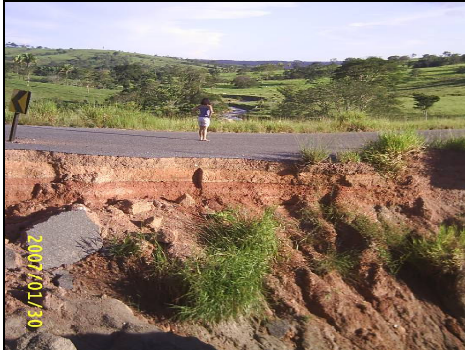
Foto 8 - Desmoronamento rodovia GO-309 Sub-bacias das Areias Coordenadas geográficas: 17° 32' 18" S e 48° 25' 56" W Fonte: Trabalho de Campo realizado em 30/01/2007 Autor: DIAS, Cristiane.
