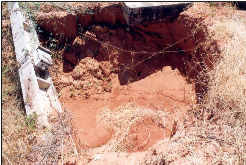
Figura 5.4 – Detalhe do colapso de terreno, mostrado na foto 5.3, que provocou a queda de um poste próximo ao pátio de tancagem da ETE/ETO.
