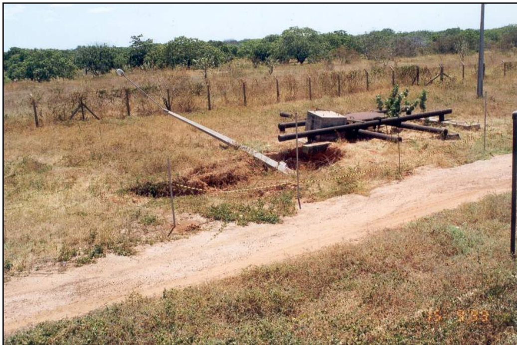
Figura 5.3 – Poste caído devido a colapso de terreno na ETE/ETO.
